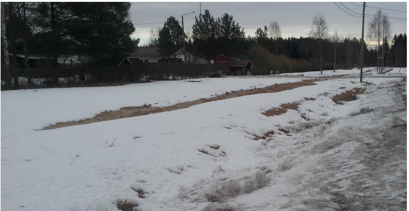
KUVA 5. Sula ja kuiva kohta maaperässä kaukolämpölinjan kohdalla, putkien sijainti lähellä pintaa
