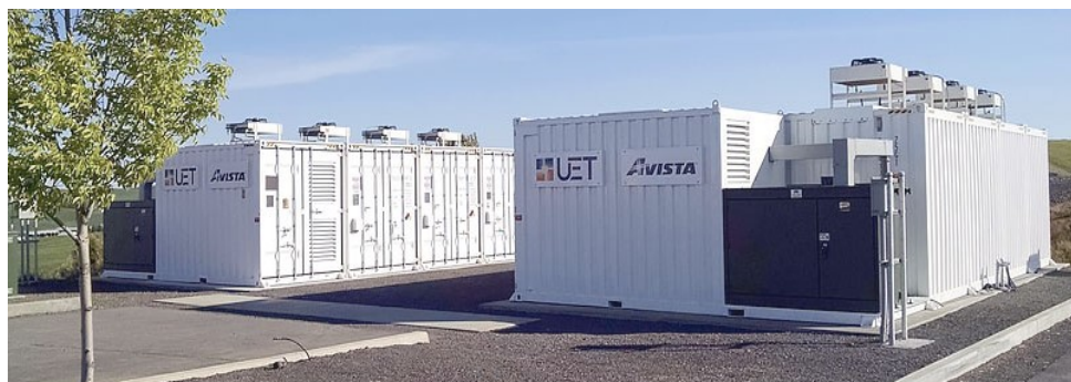
Kuva 22. 1MW:n ja 4MW:n virtausakustot (UE Technologies 2016).
