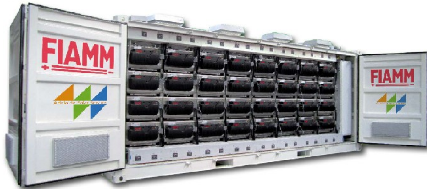
Kuva 21. Fiamm:n konttiin rakennettu 1,4MWh sähköenergiavarasto (Adelaide Solar Services 2016).
