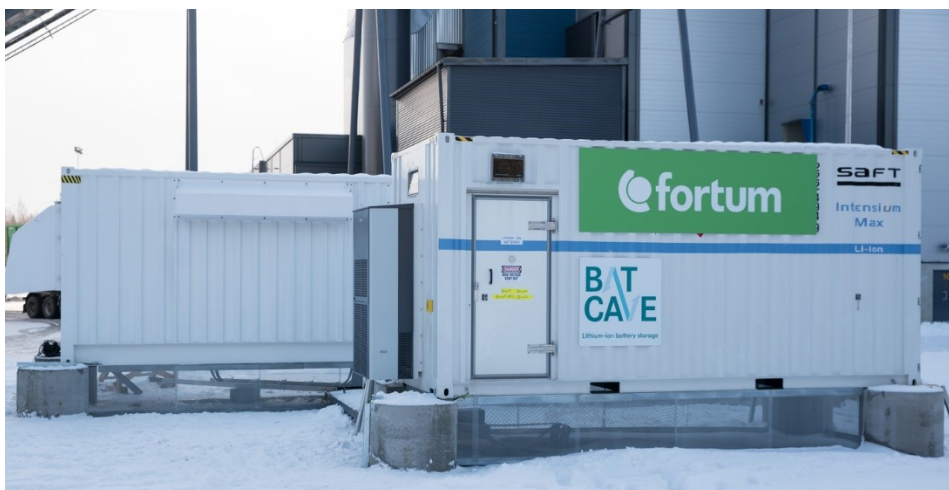
Kuva 4. Fortumin Järvenpään Sähkövarasto (Fortum 2017).
