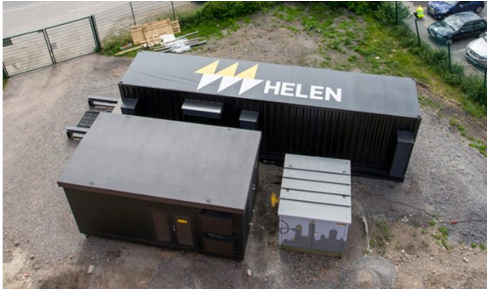
Kuva 3. Helsingin Suvilahden sähkövarasto. (Helen 2016.)
