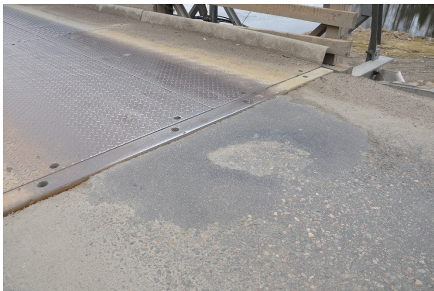
Kuva 8. Tien päällystekerros kuluu varasillan päädyissä. (Ternola 2017)
