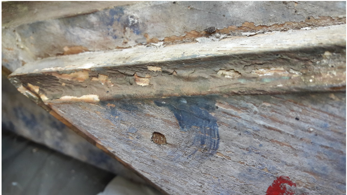
Kuva 29. Yläprofiilin koristeuran maalipinta ennen maalinkiinnitystä ja puhdistusta (Hyvönen 2017)
