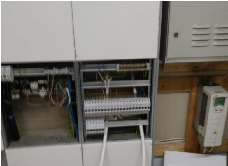
Kuva 42 Keskukselle tulevat kaapelit
