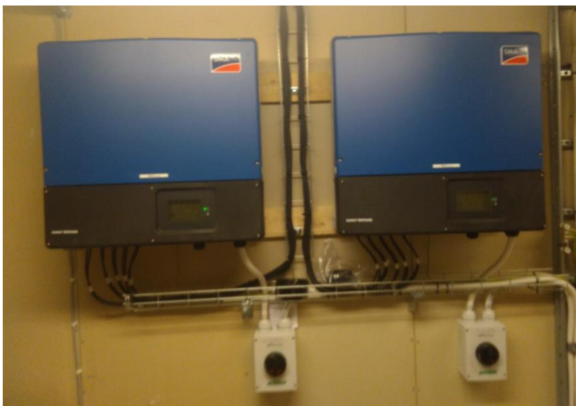
Kuva 41 Invertterit 2 x SMA 25000TL
