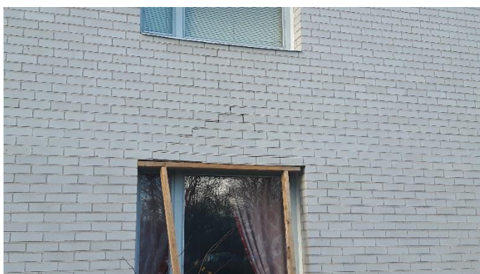
Figur 3. Sprickor ovanpå den murade gavelväggens fönster
