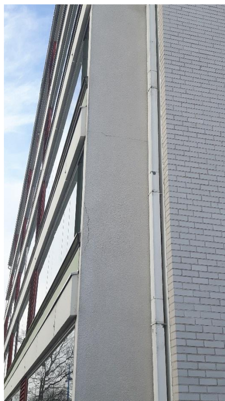
Figur 4. Synliga sprickor i balkongväggen
