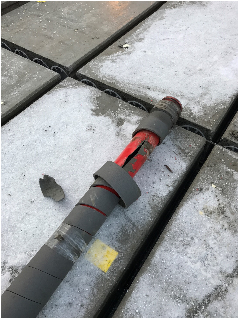
Kuva 10. Tukkeuman johdosta rikkoutunut putki (Nikkilä 2017)
