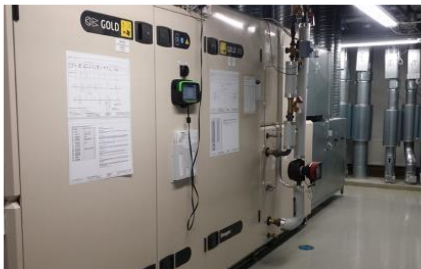
Kuva 10. Ryhmä- ja lepohuoneiden ilmanvaihtokone
