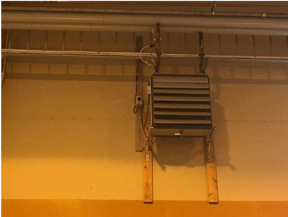
Kuva 16. Hallin katonrajassa oleva kiertoilmapuhallin.
