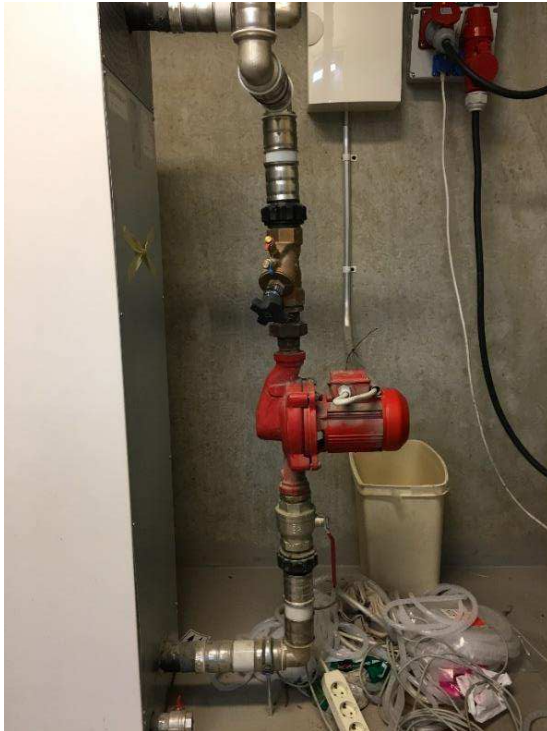
Kuva 8. Pumpun kiinnitys lämpökattilaan.
