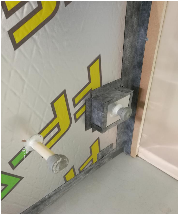
Kuva 2. Seinään kiinnitetyn alipainelaatikon läpivientejä ja tiivistyksiä.
