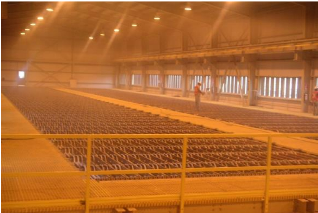
Kuva 3. Kuparielektrolyysihalli, jonka ilmassa on selkeästi näkyvissä happosumua. (9 s. 1)
