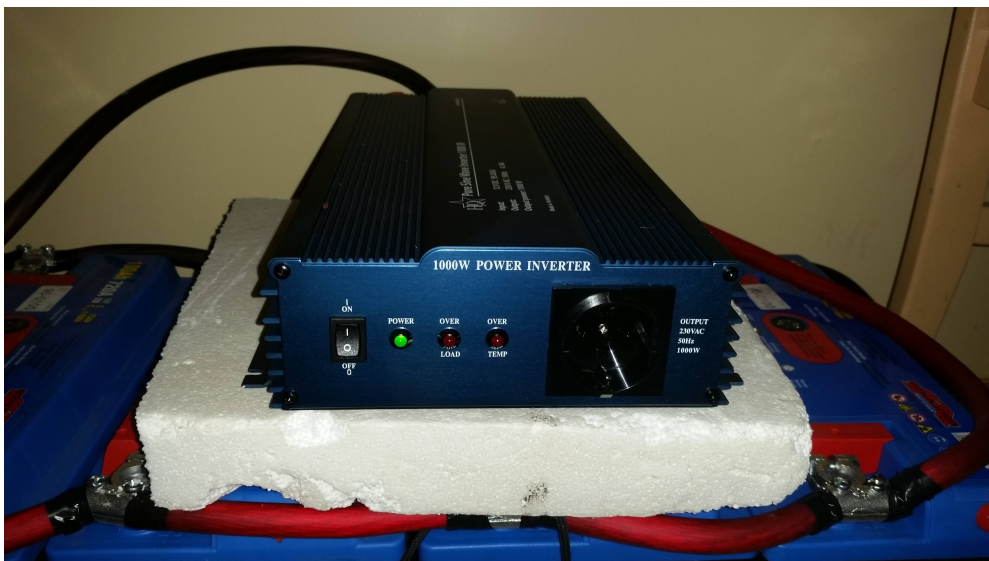
KUVA 14. Invertteri asennettuna ja toimintavalmiina
