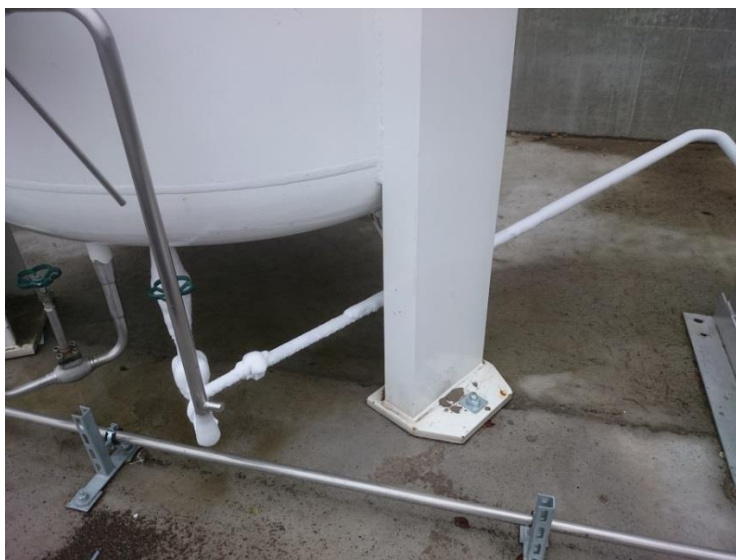
KUVA 7. Jääkerroksen kerännyt putki (Räsänen, 2016)
