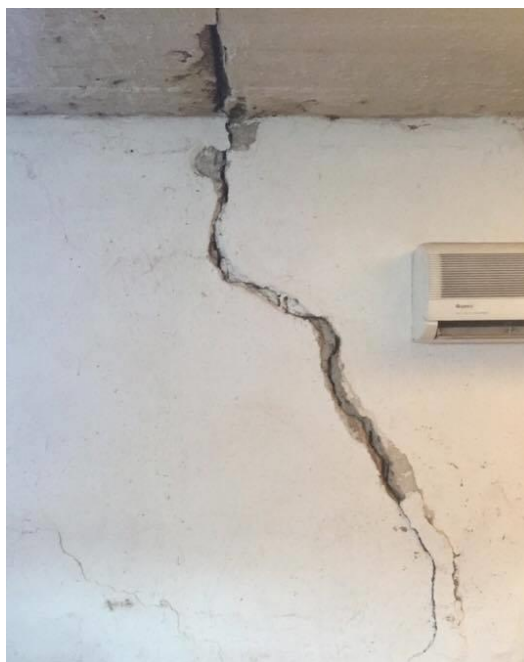
Figur 5 Sprickbildning i väggen och taket (bilden tagen 14 april 2017, Askola).
