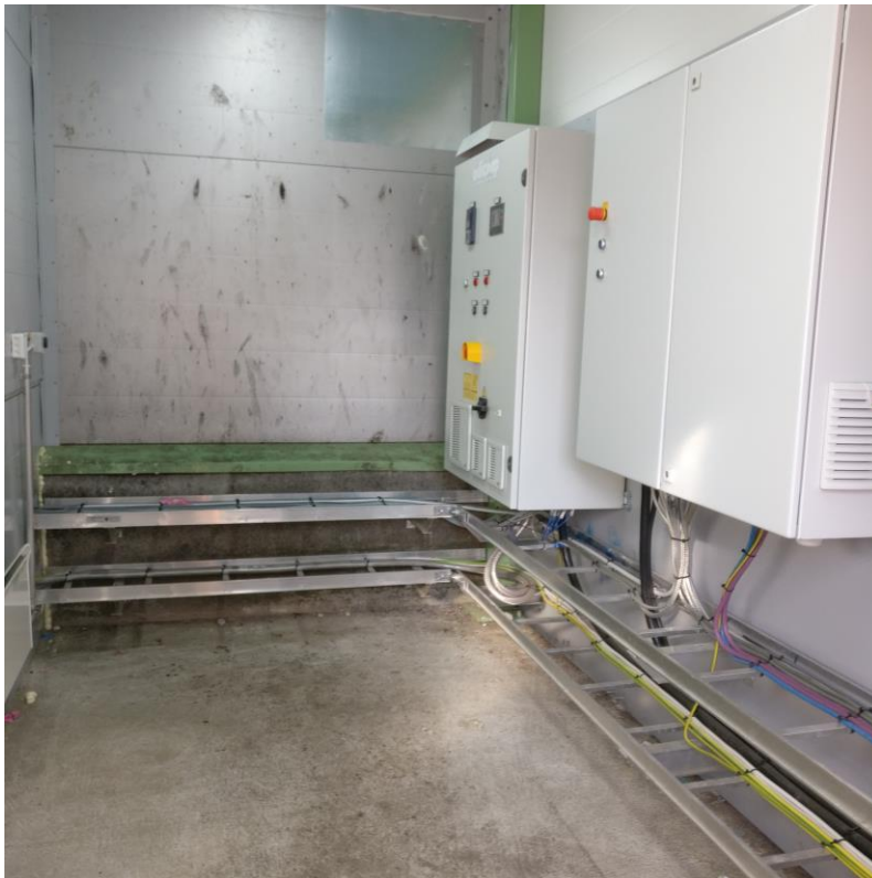
Kuva 4. Kompressorin 14-FA-02 ohjauskeskus sekä ohjauskeskus MCC-14 asennettuna sähkötilaan (Juhala 2017)
