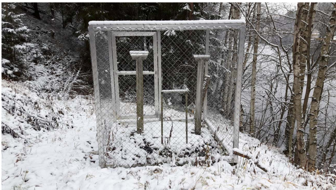
KUVA 1. Laitoksen pohjavesikaivo (Rönkkö 2016-10-27)
