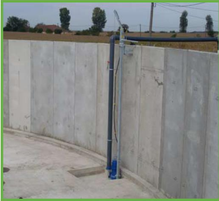
KUVIO 8. Bioreaktorin ja jälkikaasuuntumisaltaan välinen pumppu, eristämätön malli
