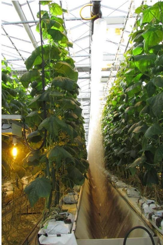
Kuva 7. Koepaikalla 1 on käytössä Novarbon pisaraverho sekä välivalot. Pisaraverho käynnistyy kun lämpötila ylittää 25°C. Pisaraverhon ollessa päällä lähimmillä riveillä tuntui selvä ilmavirtaus. (Kuva: JenniMieto)
