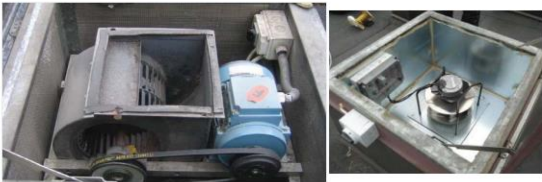
KUVA 22. Vasemmalla vanhanmallinen hihnavetoinen puhallin ja oikealla uusi energiatehokas suoravetoinen EC-puhallin (15)
