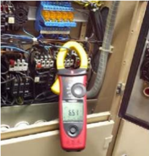
KUVA 28. Puhallinmoottorille menevän sähkövirran mittaus pihtimittarilla. (8.)
