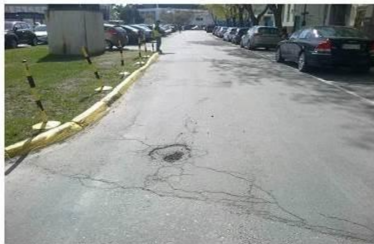
Kuva 57. Kuoppia, halkeamia ja alkavia verkkohalkeamia Palvelukeskuksen itäpuolella. (Pohjatekniikka Oy, 2014).
