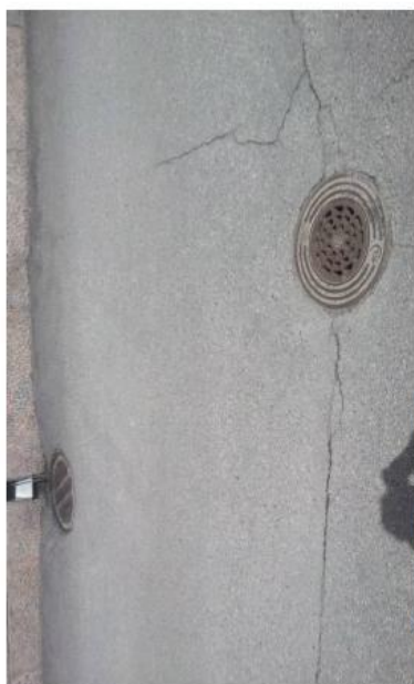
Kuva 103. Kaiivotuopissa sekä halkeamia.
