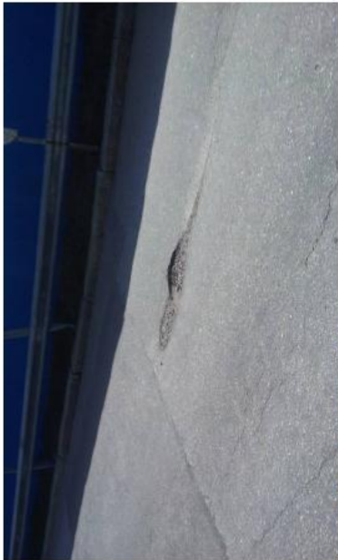
Kuva 51. Noin 7cm syvä kuoppa sekä halkeamia.
