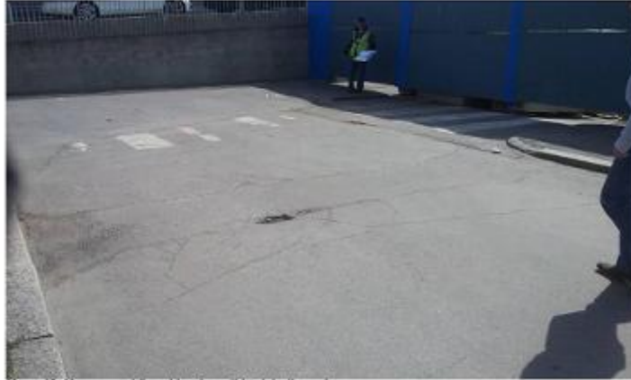
Kuva 42. Kuoppa sekä verkko- ja poikittaishalkeamia.
