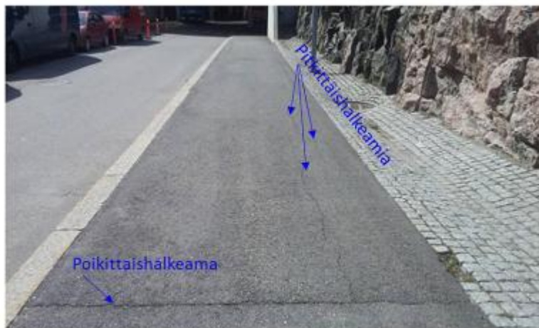
Kuva 64. Poikittais- ja Pitkittäishalkeamat.
