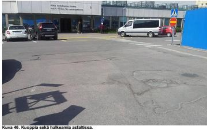
Kuva 46. Kuoppia sekä halkeamia asfaltissa.
