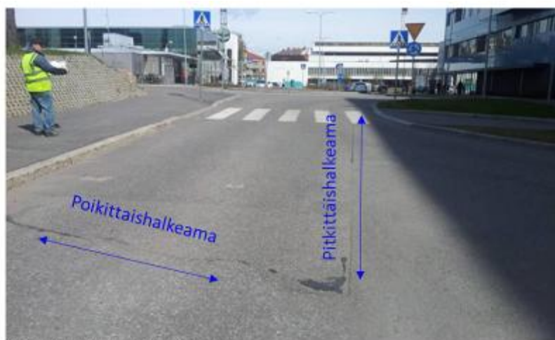
Kuva 65. Poikittais- ja pitkittäshalkeamat.
