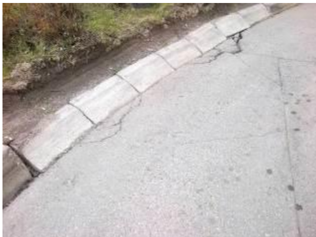
Kuva 73. Rikkoutunut reuna ja reunakivi (Pohjatekniikka, Oy 2014).
