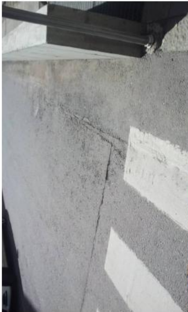
Kuva 83. Pitkittäis- ja poikittais halkeamat.
