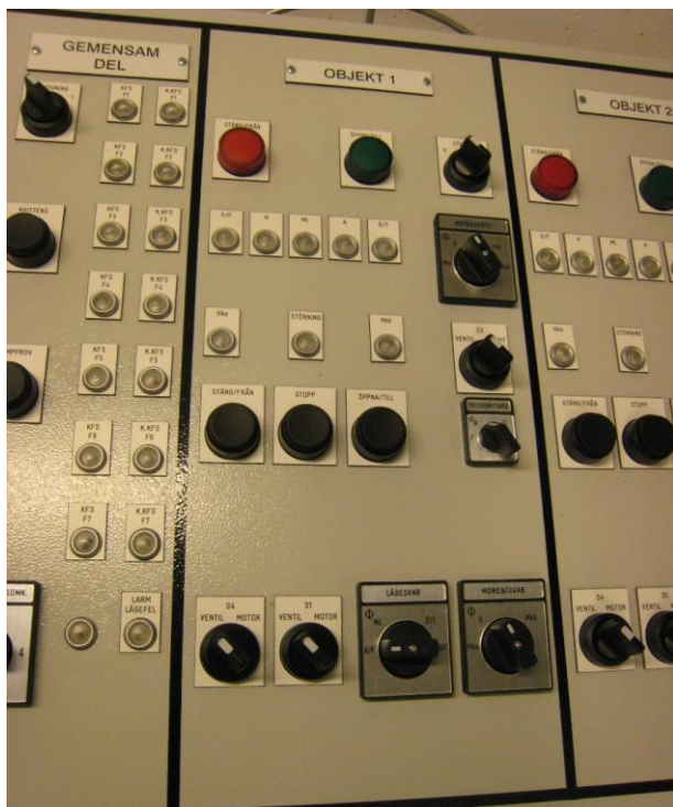
Kuva 10. Testauslaitteen etupaneelin toinen osa (TVO, 2016.)
