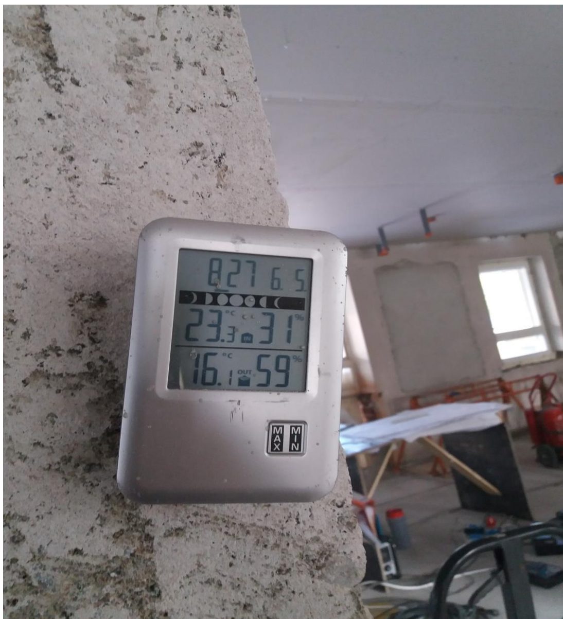
Kuva 6. Sisäilman lämpötila/kosteus mittari.
