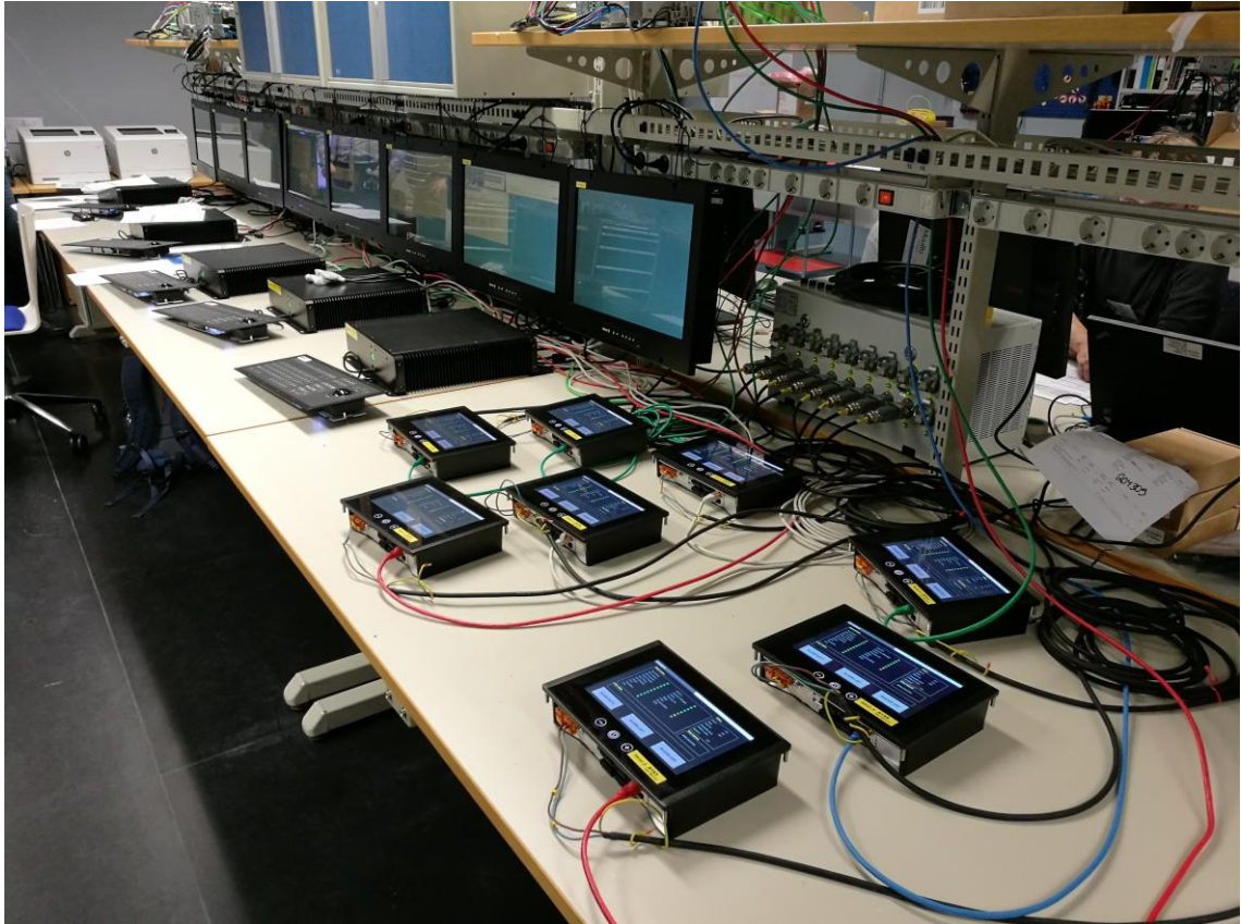
Kuva 11. IAS:n softwarin tehdaskoe, EAS-paneelit ja operointiasemat rivissä. Järjestelmän pääkomponentit testataan järjestelmätoimittajan tiloissa.
