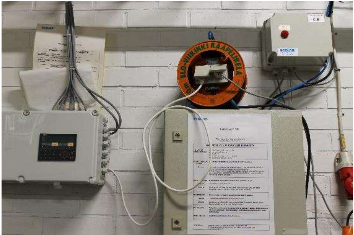
Kuva 17 PALMAT:n virtajohtoa on jatkettu jatkojohdolla
