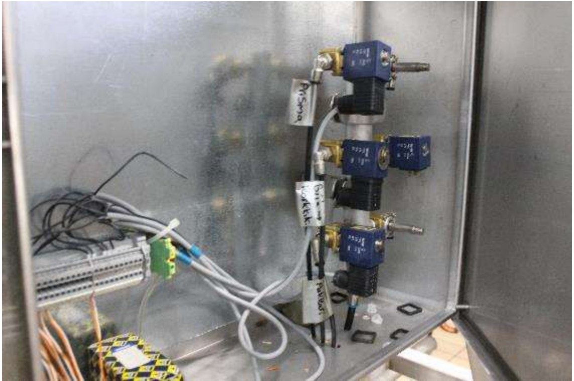
Kuva 11 Painelinjan haaroitus ja venttiilit
