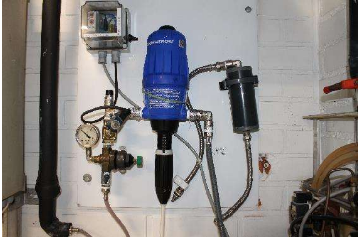
Kuva 6 Vedellisen järjestelmän injektorilla, jolla sekoitetaan voiteluaine veteen
