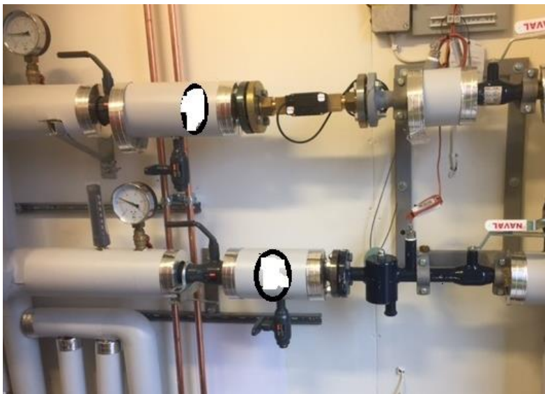
Kuva 13. Kriittisen asiakkaan kaukolämpömittaus.
