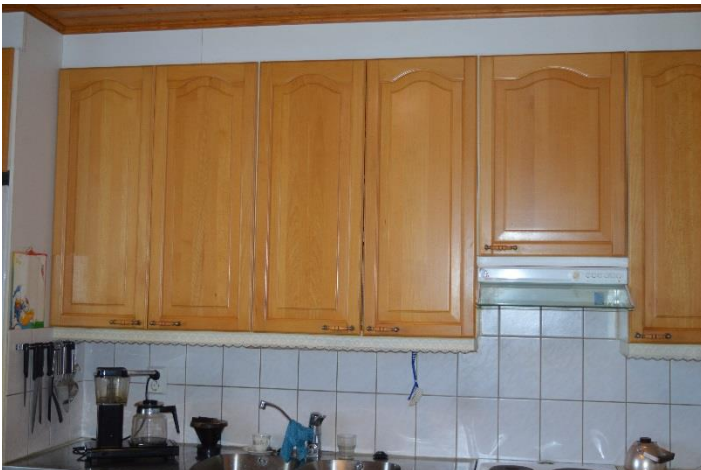
Kuva 18. Keittiön yleiskunto hyvä. Astianpesukoneen uusimisen yhteydessä keittiöön on asennettu astianpesukoneen turvakaukalo.
