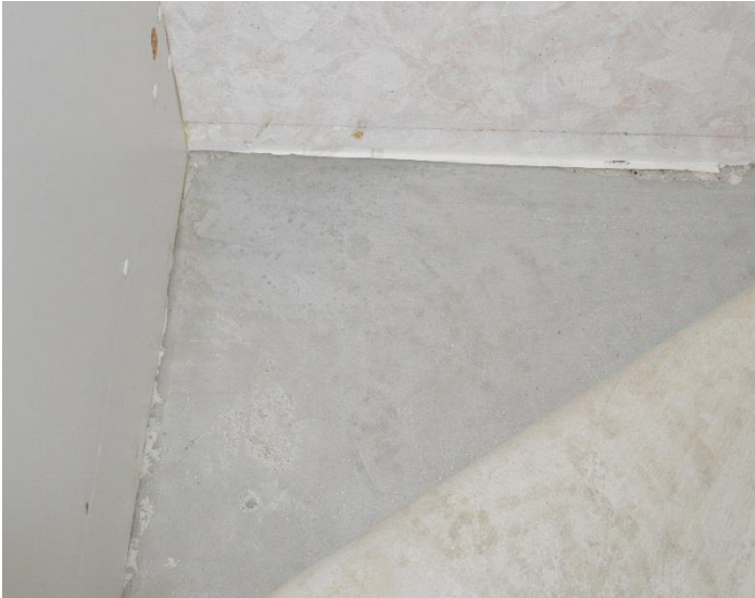
Kuva 1. Huoneen nurkka johon on porattu kooreikä. Listat ja muovimatto on irroitettu.
