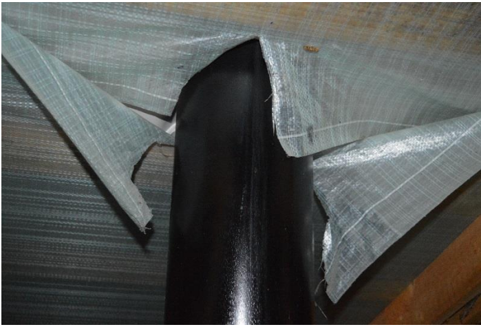
Kuva 13. Piipun läpivientä ei ole tiivistetty.
