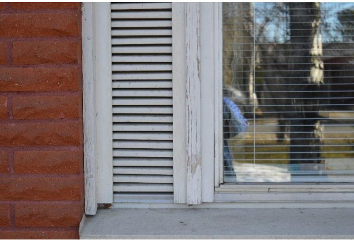
Kuva 8. Ikkunan pielissä maalin hilseilyä.
