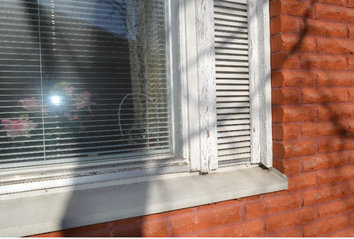
Kuva 7. Ikkunan pielissä maalin hilseilyä, varsinkin talon eteläpäädyssä. Ikkunapellitykset tiiviit.
