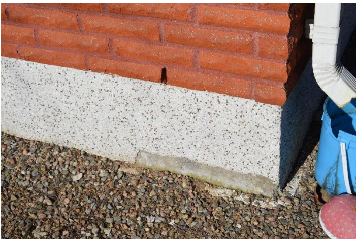
Kuva 6. Sokkelin rappaus paikoitellen hilseilyt.
