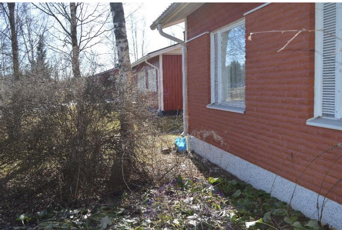
Kuva 3. Puustoa ja pensaikkoa liian lähellä ulkoseinää.
