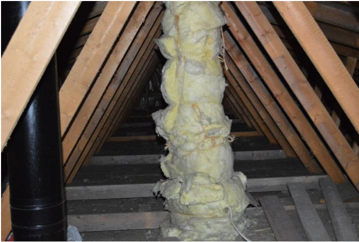
Kuva 14. Ilmastointiputken eristys kyseenalainen.
