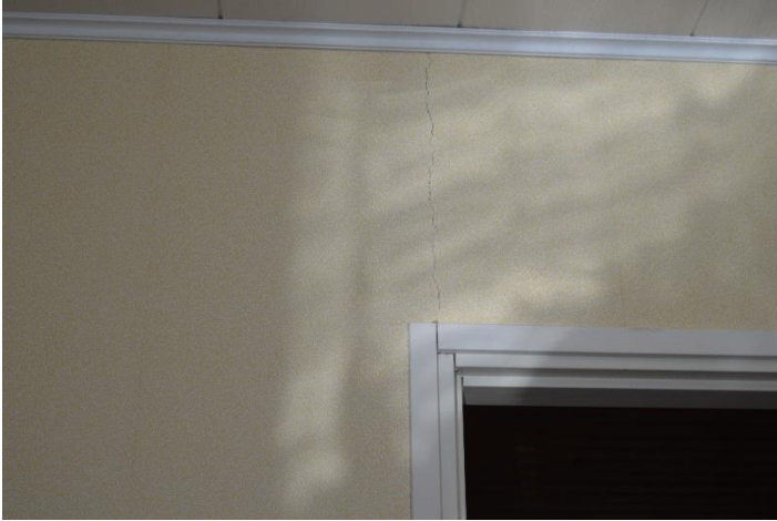
Kuva 16. Tapetti paikoin repeytynyt levysaumojen kohdalta.
