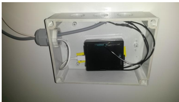
Kuva 4. Arduino koteloiissaan (kuva omasta laitteesta).
