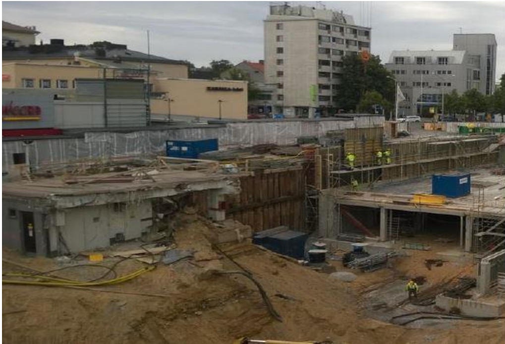
Kuva 5. Vanha muuntamo työmaa-alueella
