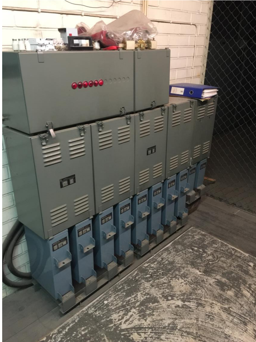
Kuva 5. Kiinteistön vanhat, mutta käytössä olevat kompensointiparistot. Kuvassa näkyy yksi kohteen puutteista, sillä kompensointiparistojen päällä ei saisi säilyttää edes vähäistä määrää tavaraa. Tämä toimii erittäin hyvänä esimerkkinä huolto-ohjelman tärkeydestä, sillä vuosittaisilla tarkastuksilla voidaan puuttua näihin asioihin.
