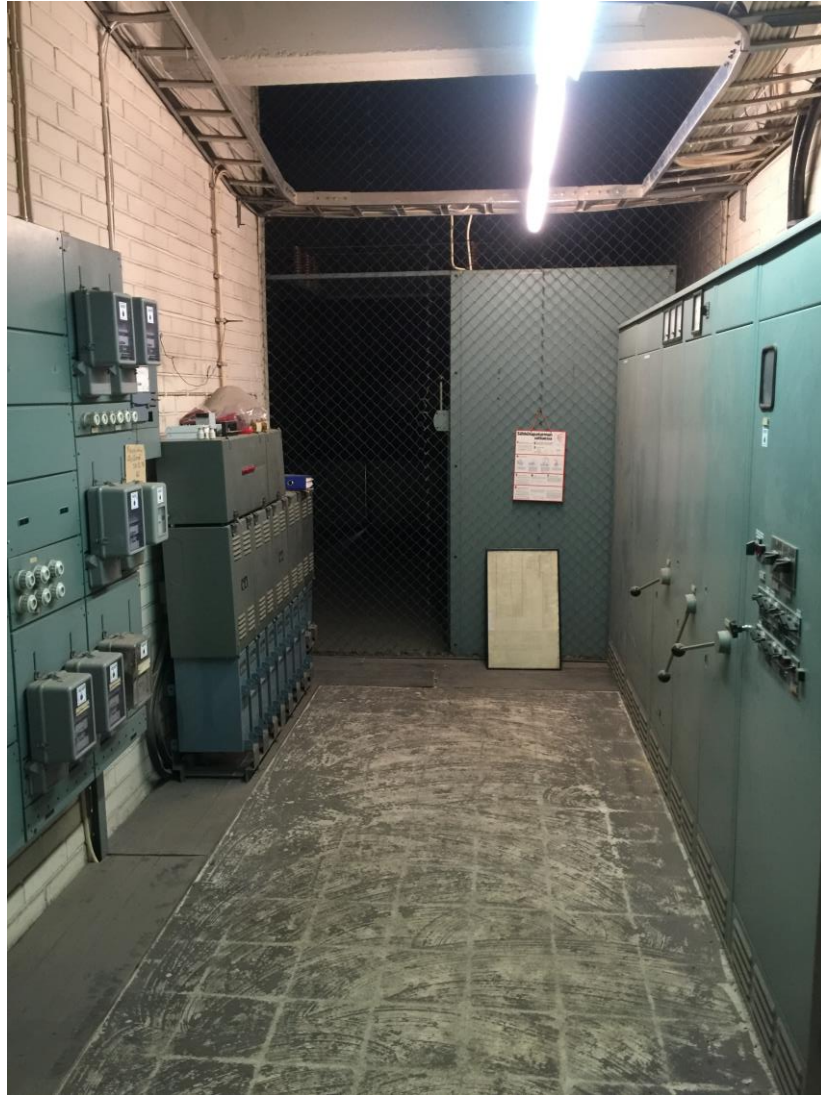
Kuva 4. Kiinteistö sähköpääkeskus joka on erotettu muuntamosta verkkoseinällä. Sähköpääkeskus on erittäin siisti vain muutamaa poikkeusta lukuunottamatta (kuva 5). Vasemmalla näkyvät tilojen omat sähkömittarit sekä niiden jälkeen kompensointilaitteisto.
