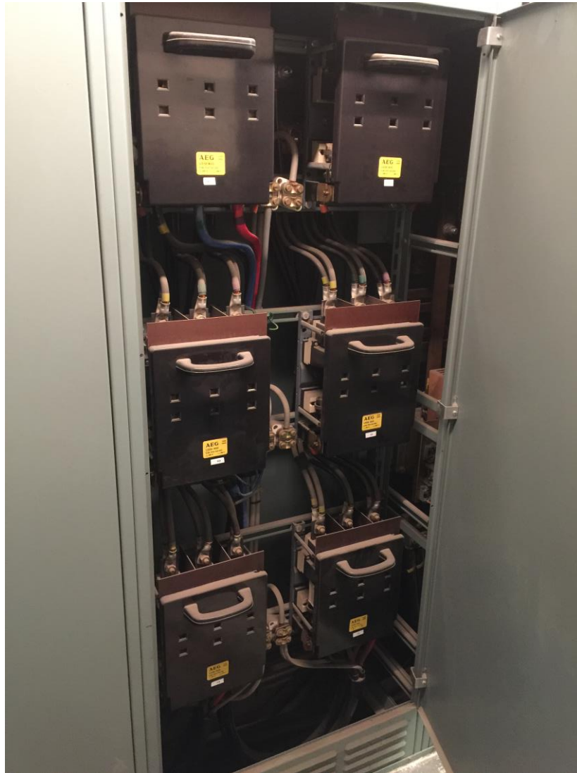
Kuva 6. Pääkeskuksessa sijaitsevat uuniluukkukytkimet jotka saattavat aiheuttaa vaaratilanteita väärin käytettynä.
