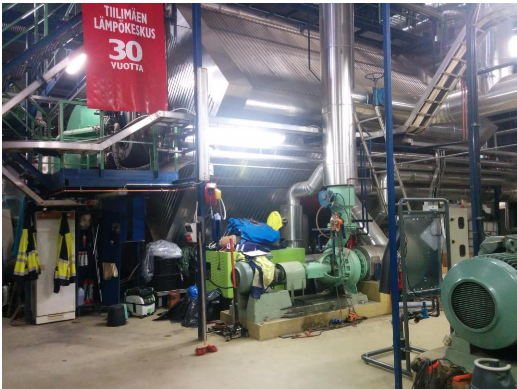
Kuva 11. Tiilimäen lämpökeskuksen kaukolämpöpuoli. (Peltomaa, T. 2017)
