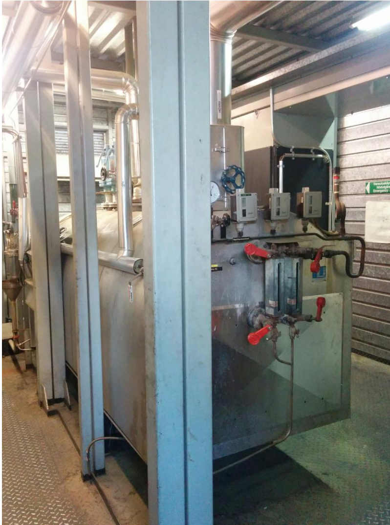
Kuva 4. Sähkötoiminen höyrykattila (Peltomaa, T. 2017)
