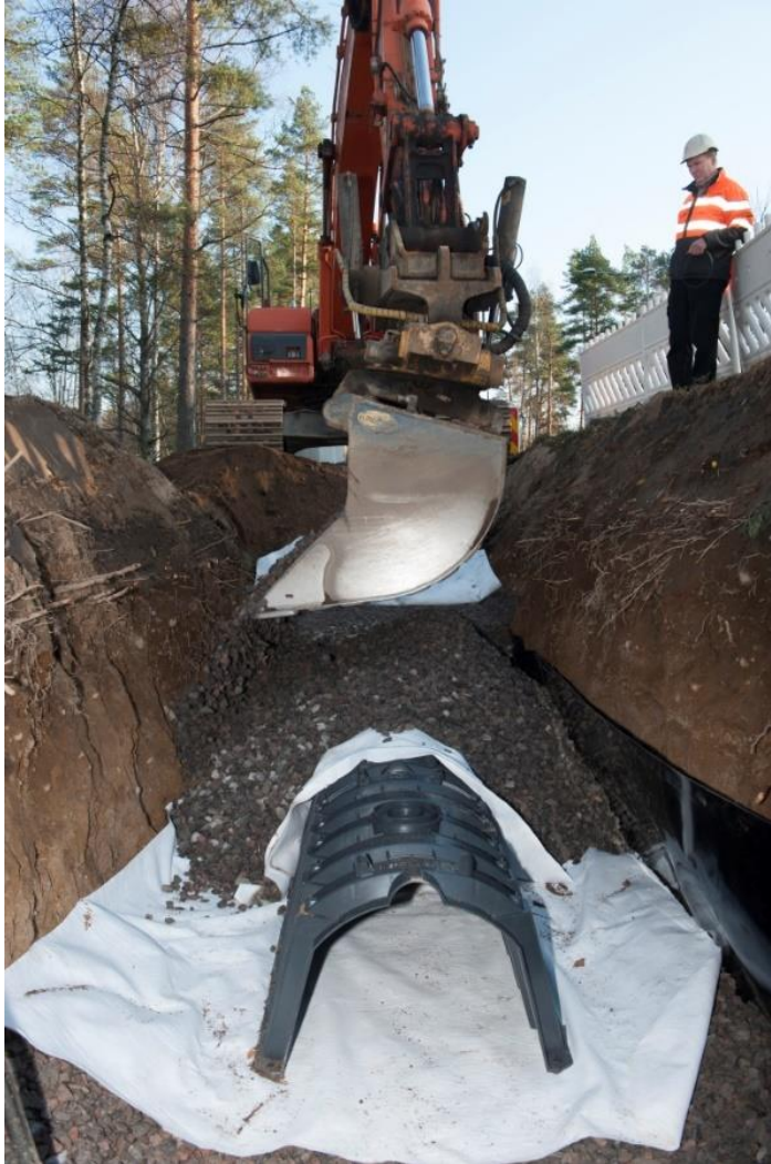
Kuva 2. Uponorin hulevesitunneli (Uponor 2016).
