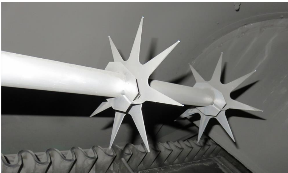
Kuva 15 Kotelon sisällä olevat koronaelektrodit
