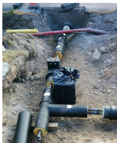
Kuva 36. Kuvassa on tehdasvalmisteinen tahaara, jätesäkissä vastusrenkaita liitosmuhveihin, säkin takana maaventtiilielmentti. Etualalla olevat putkenpäät on tulpattu. Putkiin liitetään asiakas kesällä 2017.
