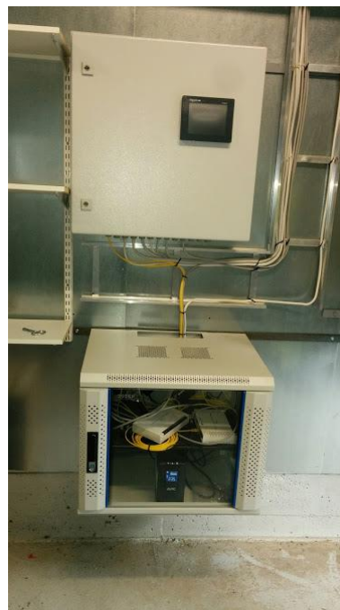
Kuva 21. Etäohjattavan venttiiliaseman aivot. Ylempi kaappi on paikallisohjaus, sillä ohjataan Auma-merkkisiä venttiileitä paikallisesti, se on varustettu pienellä näytöllä. Alempi kaappi mahdollistaa etäohjauksen ja sisältää varavirtalähteen.
