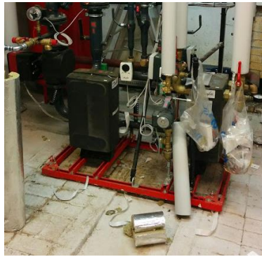
Kuva 33. Tässä on asennus loppusuoralla. Laitteisto on otettu käyttöön 2016. Tämä vie tilaa sen verran kuin viereisessä kuvassa tuo suurempi kelkkinen lämmönvaihdin.
