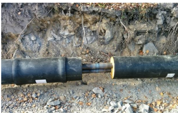
Kuva 37. Laadukkaasti ammattilaisen tekemä hitsausliitos. Kuvassa vasemmalla näkyy liitosmuhvi, mikä kiinnitetään vastusrenkailla liitoksen päälle, muhviin tehdään reiät ja eristäjä täyttää liitokset asianmukaisesti, sen jälkeen reiät tulpataan huolellisesti. Häätapauksissa ja pienissä kohteissa lämpöyhtiöllä on mahdollisuus suorittaa eristäminen ammattimaisesti omin voimin. Pääsääntöisesti liitos- ja eristystyöt tekee siihen erikoitunut yritys.
