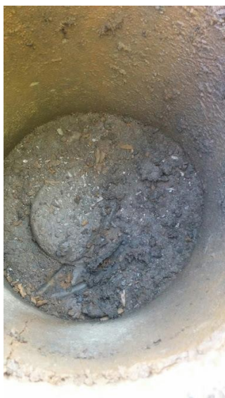
Kuva 23. Tähän kaivoon ei ole hetkeen kurkattu tai putsattu, venttiilin suojakansi näkyy hieman vasemmassa reunassa
