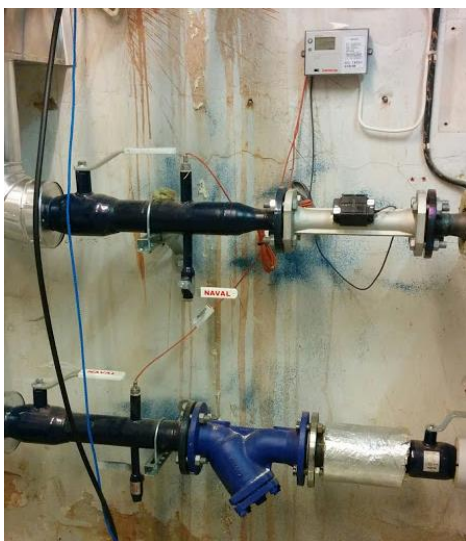
Kuva 31. Uuden asiakkaan tiloihin asennetut lämmönmyyjänlaitteet ovat: lämpömääränsäkin, mutataku, sulkuventtiilit, virtausputki, lämpö- ja virtasanturit.
