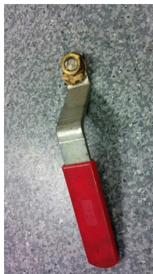
Kuva 30. Sulkuventtiilin kara oli hapettunut ja katkesi yritettäessä venttiiliä sulkea kuntokierroksen yhteydessä
