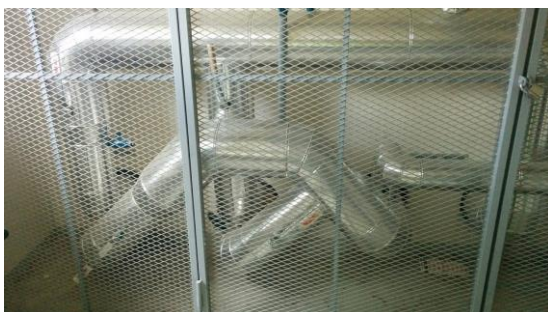
Kuva 20. "Lihasvoimalla" toimiva venttiiliasema sijaitsee kerrostalon kellarissa ja on aidalla eristetty muusta tilasta, ovi on varustettu lämpöyhtiön riippulukolla.
