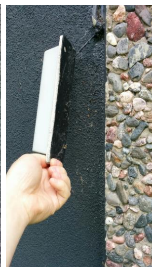
Kuva 29. Julkisivuremontin yhteydessä oli unohtunut kiinnittää antenni uudelleen.
