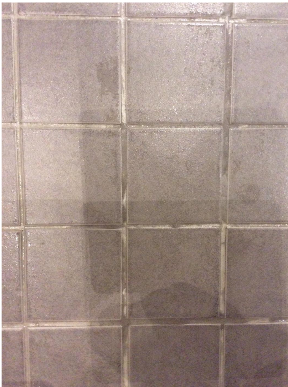
Kuva 8. Kuivuneissa saumoissa näkyy haaleampia kohtia johtuen mahdollisesti virheellisestä saumaustyöstä (Hanhinen Ville 2015)
