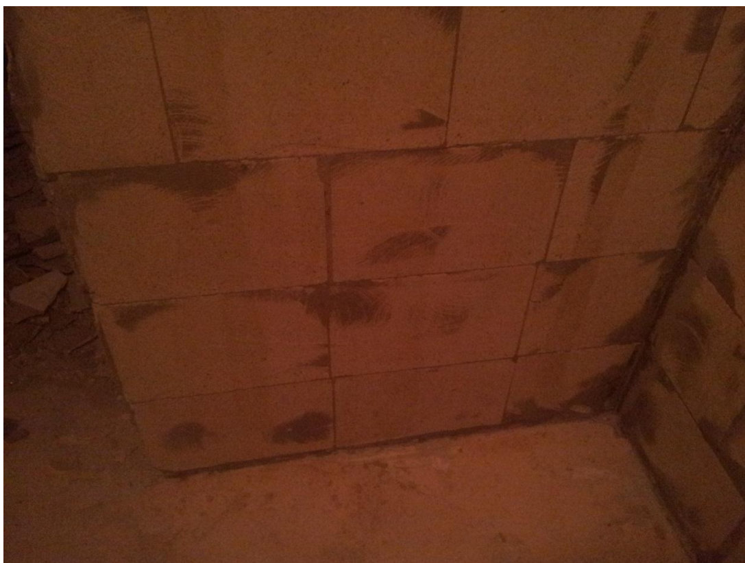
Kuva 3. Väärin muurattua kahitiiliseinää jaon suhteen. Alaosa myös vinossa pystysuunnassa seinän yläpäähän verrattuna n. 30 mm (Hanhinen Ville 2016)
