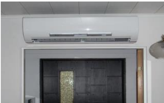
Kuvio 8. Ilmalämpöpumpun sisäyksikkö
