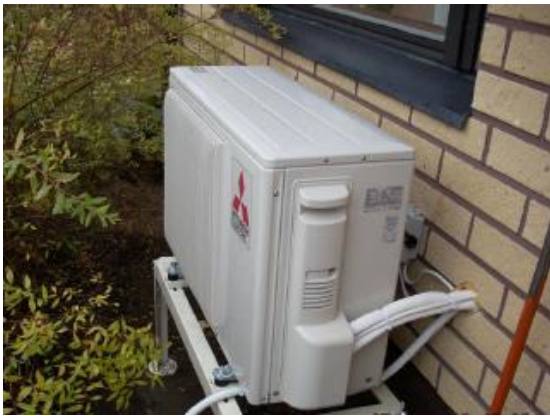
Kuvio 7. Ilmalämpöpumpun ulkoyksikkö
