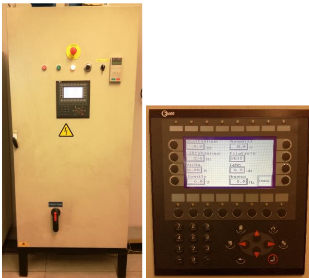
Kuva 5. Taajuusmuuttaja ja sen ohjaus suurennettuna
