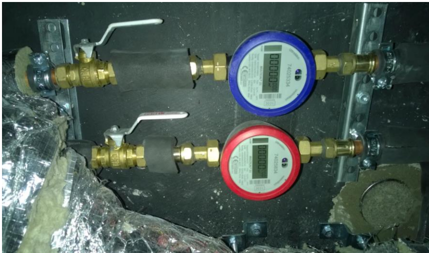
Kuva 12. Näkymä vesimittareille huoltoluukusta.
