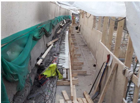
Kuva 5 Vilkasliikenteisellä siltapaikalla sekä alittavaa että ohittavaa liikennettä on suojattu pressulla ja vaneriseinillä. Vuodenajasta johtuen suojauduttiin myös lumisateelta.
