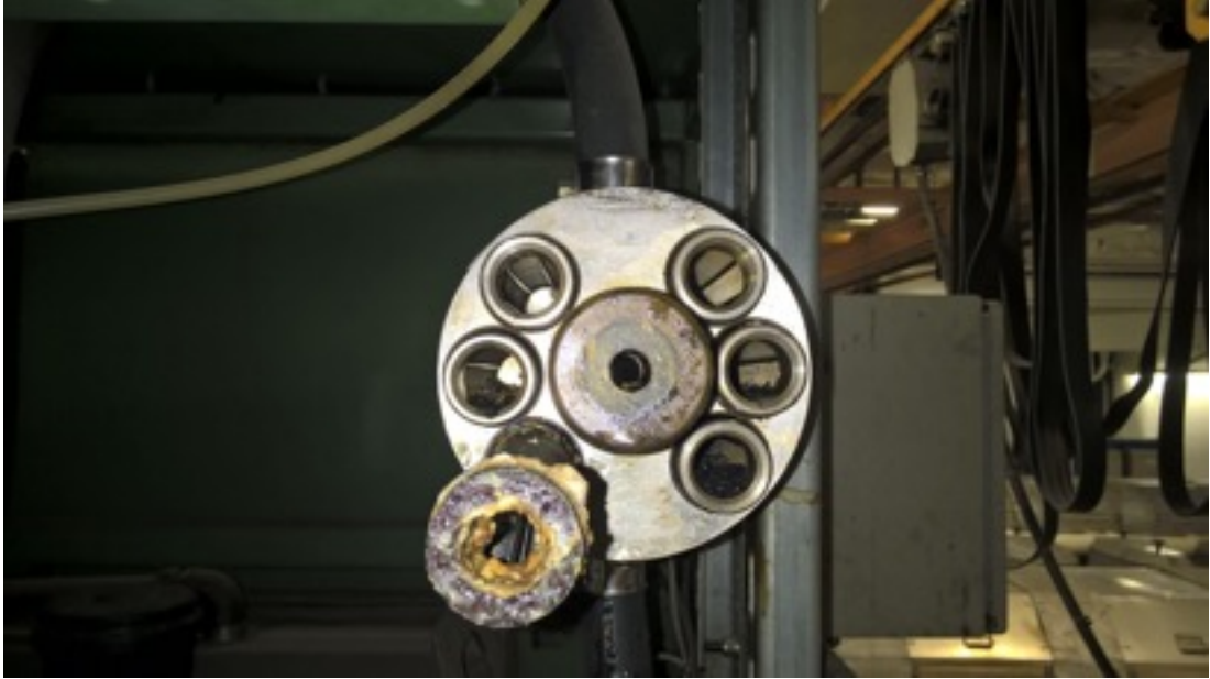
Kuva 2. Automaattisuodattin avattuna. Huomaa yhden patruunan korroosio; väärä materiaali (alumiini). Suodatinpatruunoissa myös kiintoainetta, eli suodatin ei ole toiminut oikein. Kuva: Mika Savila 2016
