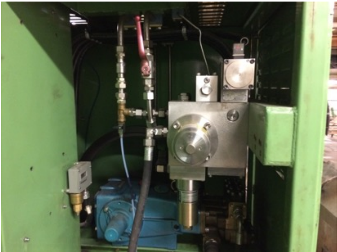
Kuva 7. Korkeapaineysikön venttiilikoneikko. Venttiiliblokin kyljesä pulsaatiovaimennin, päällä kevennys- ja linjasäätöventtiili. Kuva: Mika Savila 2016
