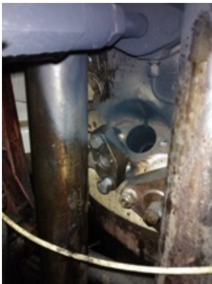
Kuva 8. Irronnut suuttimen tulppa. Kuva: Mika Savila 2015
