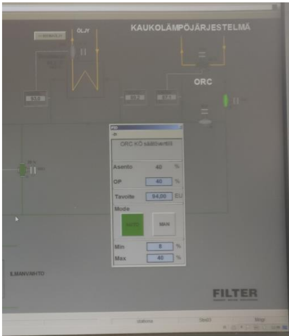
KUVA 6. ORC kuumaöljysäätöventtiilin säätö CHP-laitoksen valvomon tietokoneelta
