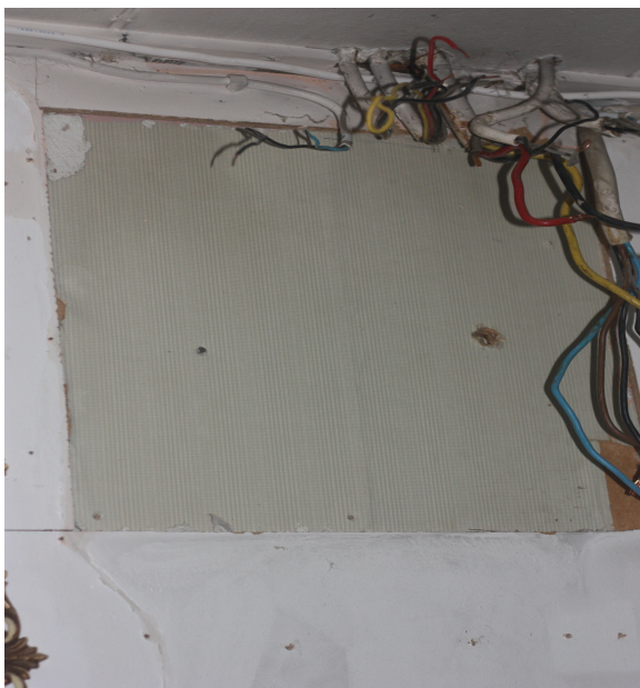
KUVA 3. Vanha pääkeskus irroitettu. Keskuksen alla on levynpala, joka saattaa sisältää asbestia.
