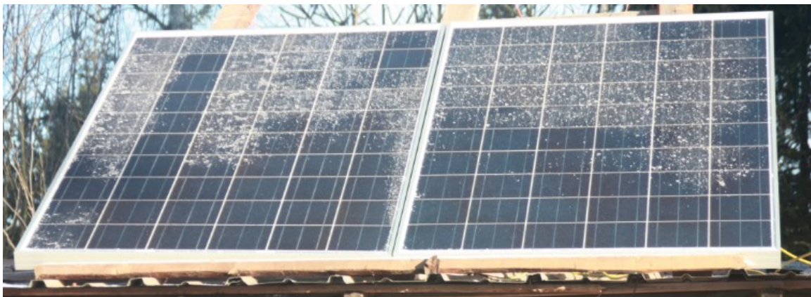
KUVA 14 Aurinkopaneelit 2 x 250 W ulkorakennuksen katolla kiinteästi asennettuna
