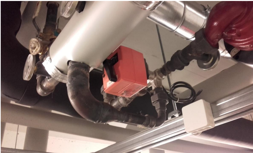
KUVA 14. AS Oy liriksen lattialämmitysten kolmitieventtiili
