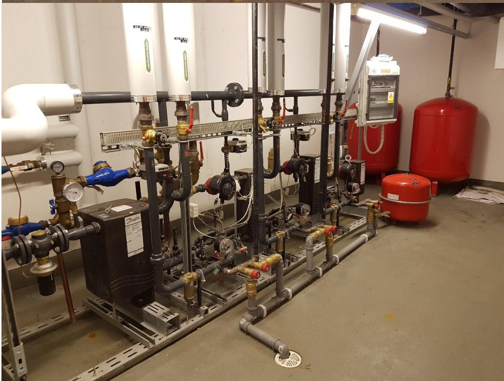
KUVA 12. As Oy Iiris lämmönjakokeskus
