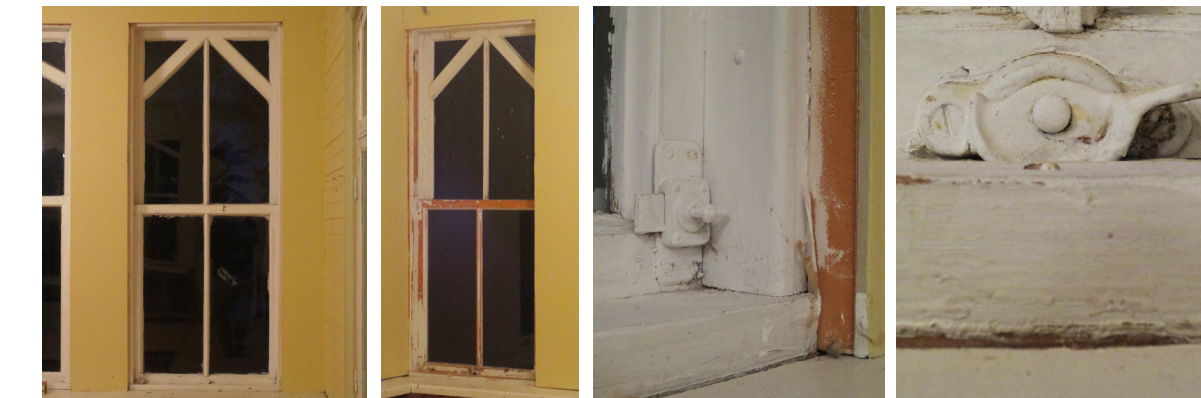
Ikkunat ovat vaihtelevassa kunnossa.
