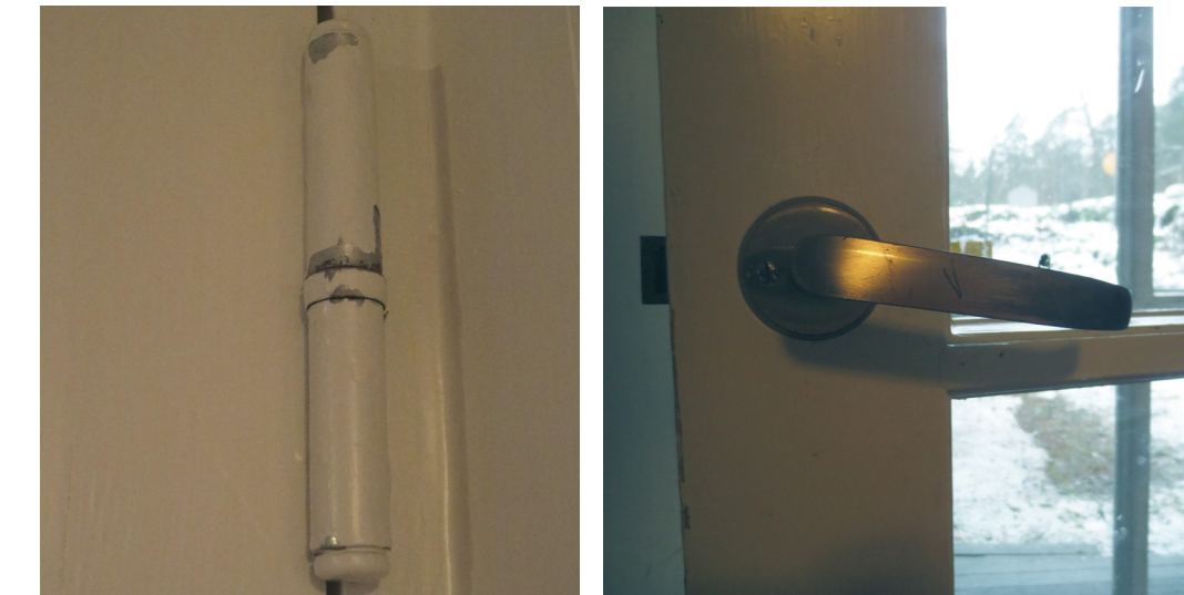
Oven ja saranoiden maalipinnoissa on pientä kulumaa.
