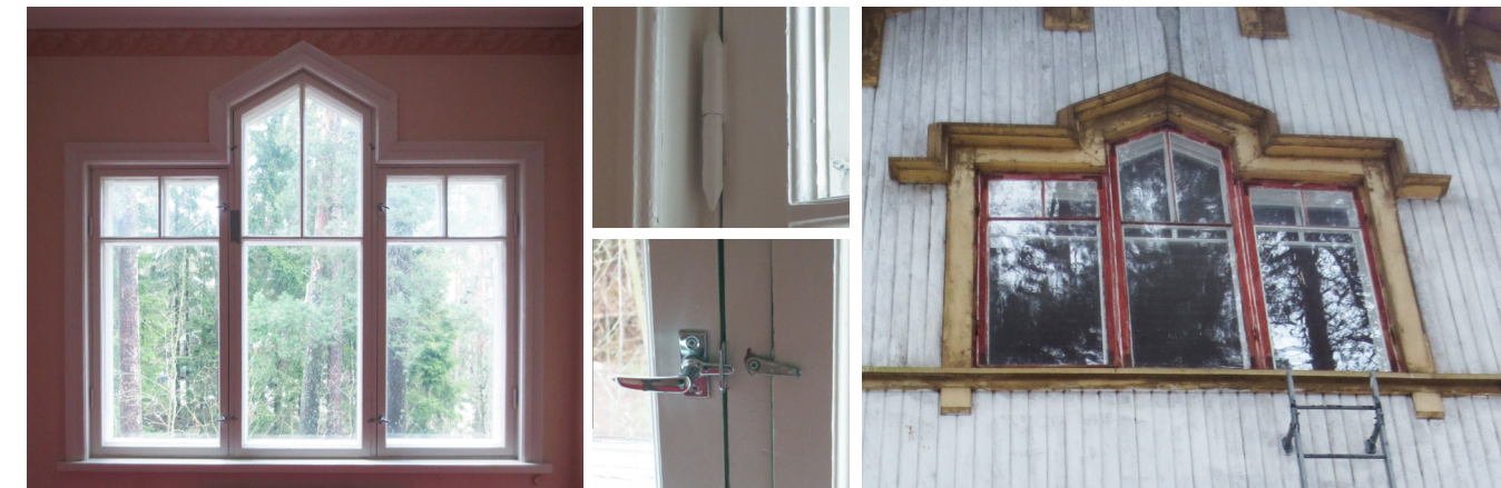
Keskimäinen ikkuna on irrottavissa kokonaan. Sarana ja ikkunasulkija. Kyntteen puoli kaipaa kunnostusta.
