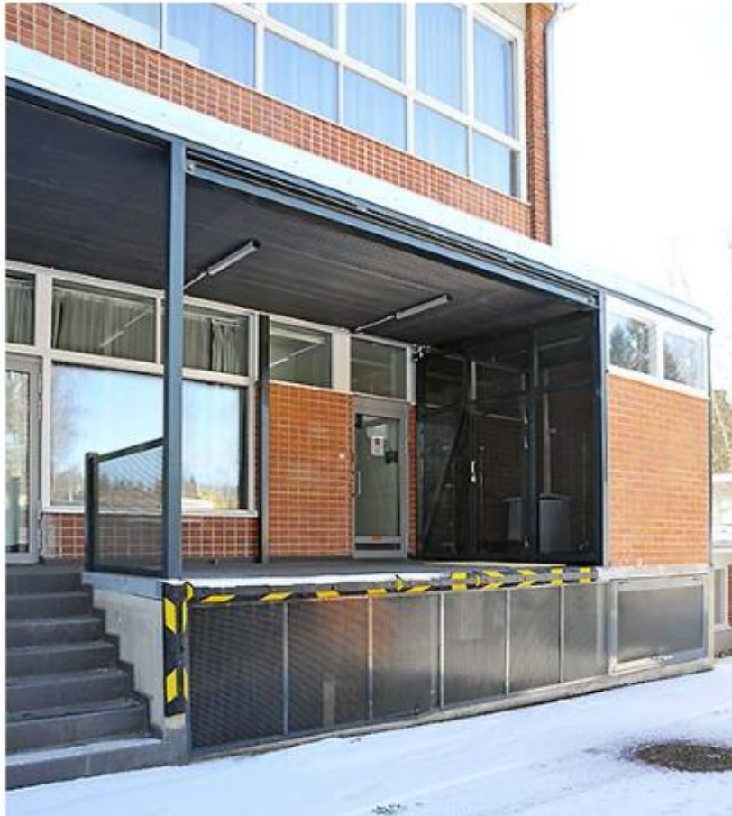
Kuvio 9. Keittiön lastauslaituri, minkä yhteydessä rullakoiden ja laatikoiden varastointitilat sekä laiturin alle sijoitettu keittiön kompressorilauhdutinyksikkö. (RT 94-11254 2017, 7.)
