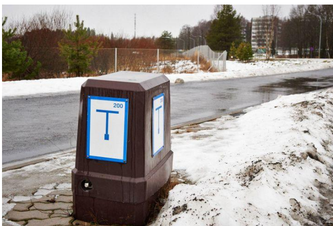
Kuva 7. Palovesiasema ja merkkikilpi (kainuunsanomat.fi)
