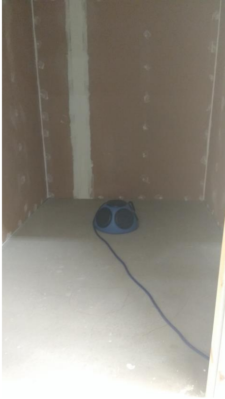
Kuva 5. Äänilähde paikoillaan lähettävässä tilaelementissä.
