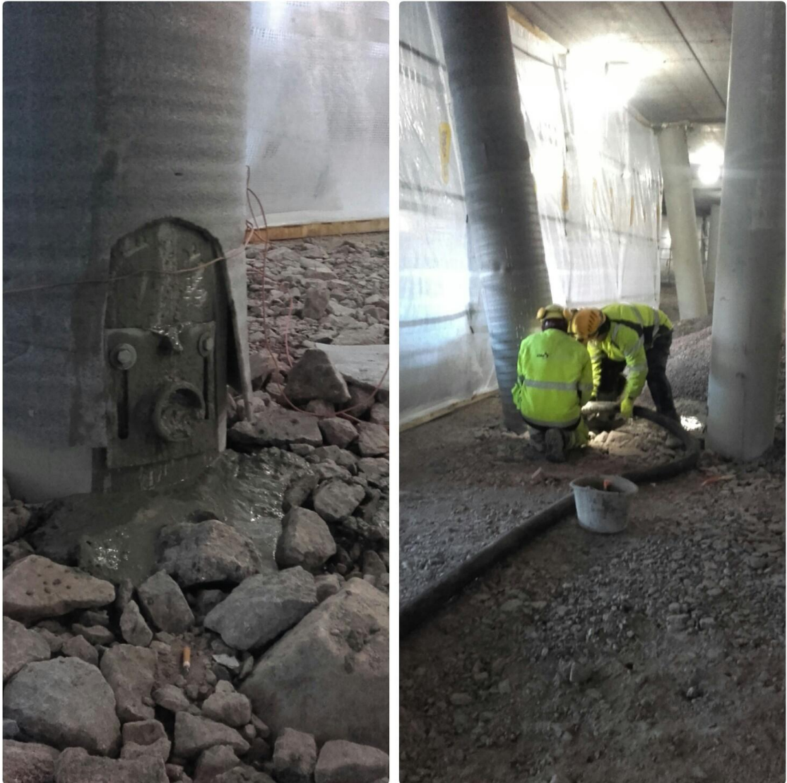
Kuva 20. CFT-pilarin valuyhde suljetaan betonoinnin jälkeen, 20a. Betonin pumppausputki siirretään pikaisesti seuraavalle pilarille, kun valuyhde on saatu suljetuksi, 20b [34].
