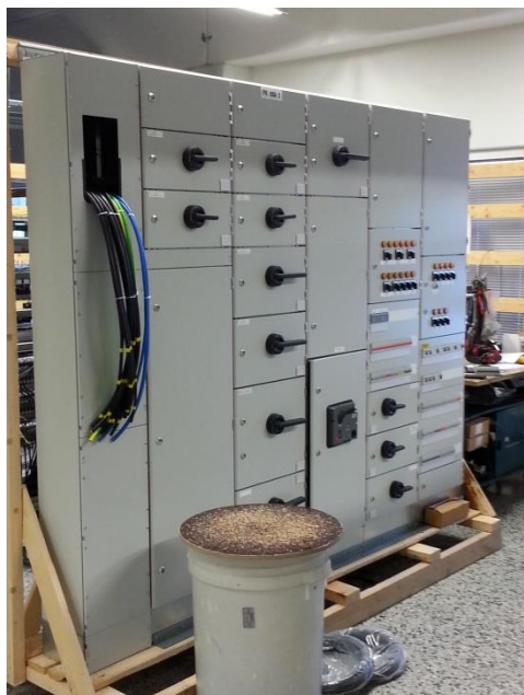
KUVA 10. Pääkeskuksen osa 2 (Valtimon sähkötyö Oy 2015.)
