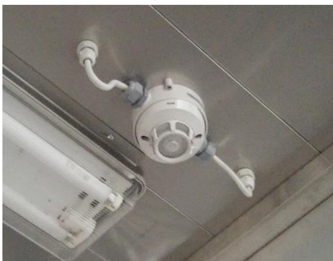
KUVA 19. Paloilmoitin asennettuna keittiön huuvaan (Honkanen 2016.)
