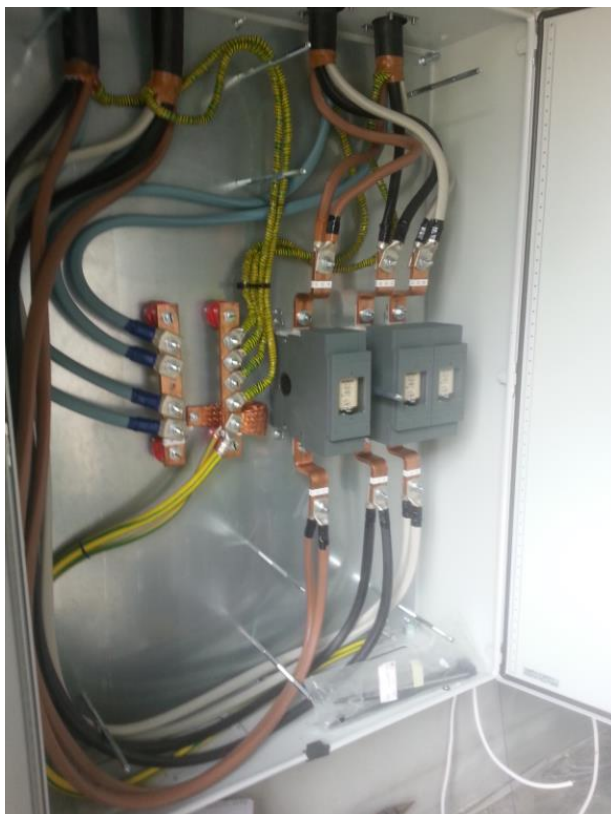
KUVA 28. Syöttökaapelit kytkettynä kahvasulakkeille (Honkanen 2016.)
