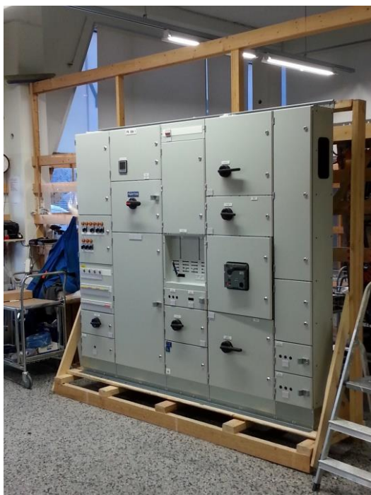
KUVA 9. Pääkeskuksen osa 1 (Valtimon sähkötyö Oy 2015.)
