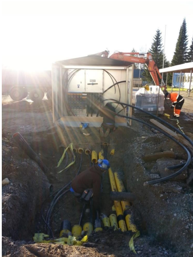
KUVA 7. Puistomuuntamon liittymien kaapelointia (Valtimon sähkötyö Oy 2015)
