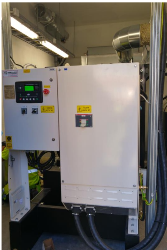
KUVA 23. Varavoimakoneen ohjauskeskus sekä katkaisija Q1 (Honkanen 2016.)
