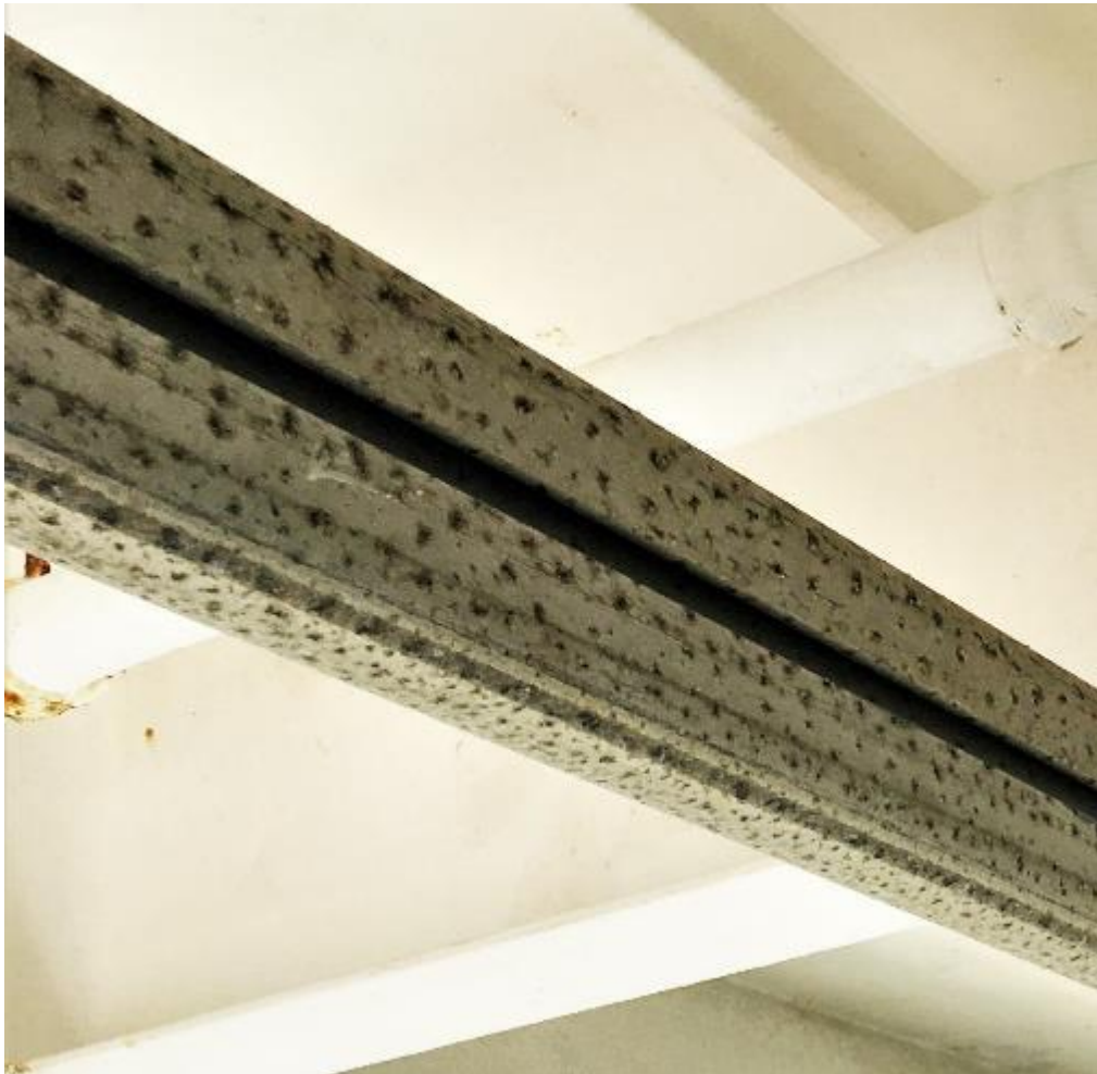
Kuva 7.3 Pistesyöpymistä kulkukiskon pinnassa.
