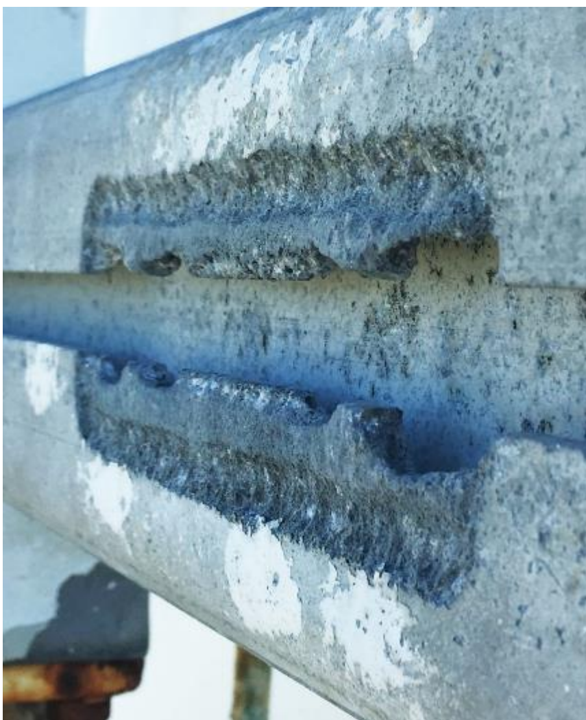
Kuva 7.2 Korroosio kiskonkannakkeen kohdalla.
