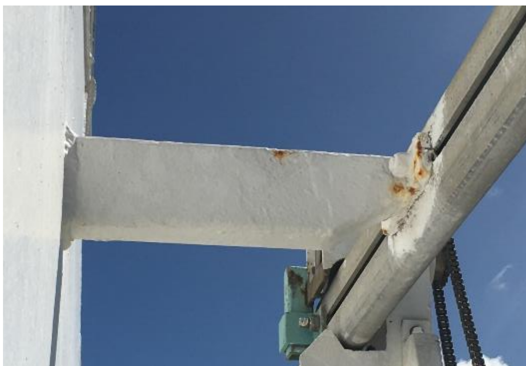
Kuva 6.1 Kiskon kannattimen korroosio.
