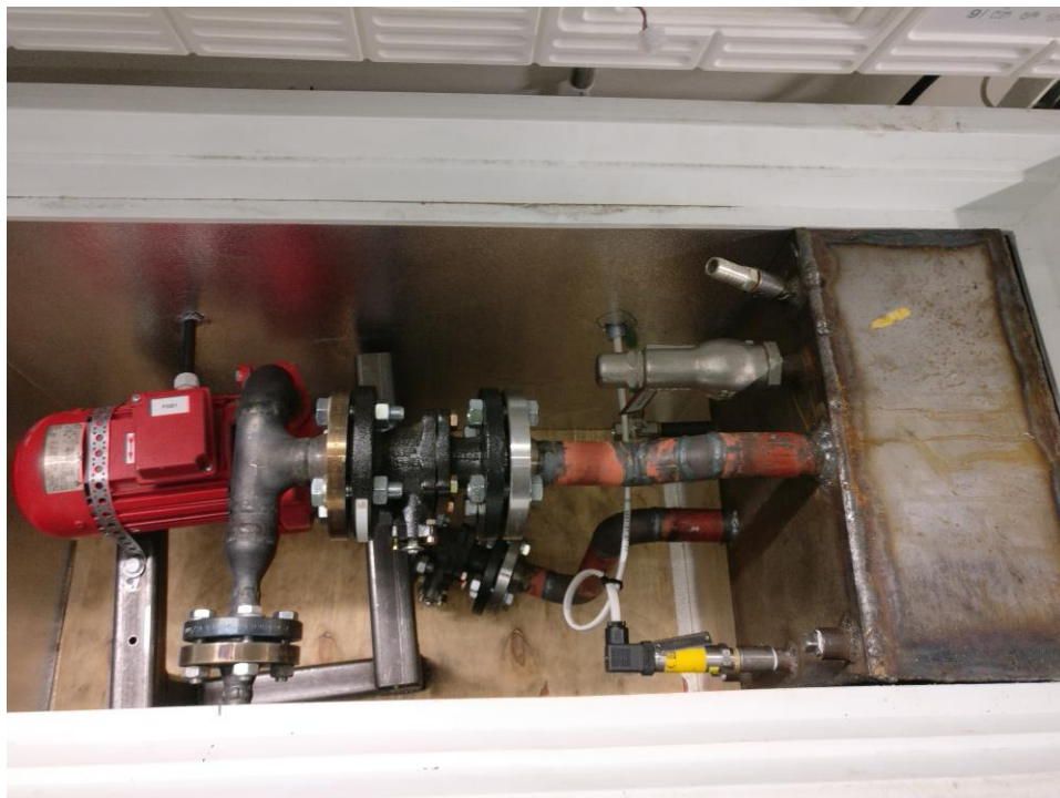
KUVA 3. Pakastimen sisällä on pumppu ja ammoniakisäiliö.
